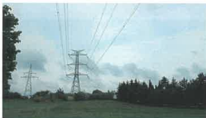
Przęsło 9 – 10 linii 2 x 400 kV
