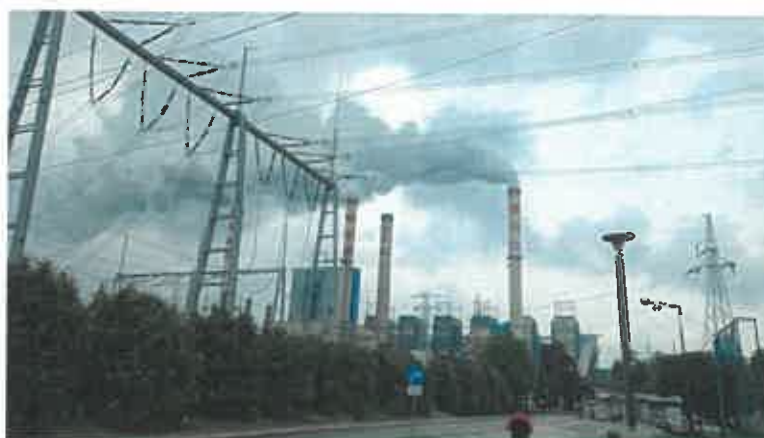
Przešlo bramka SE przy Elektrowni Pątnów – słup nr 1
